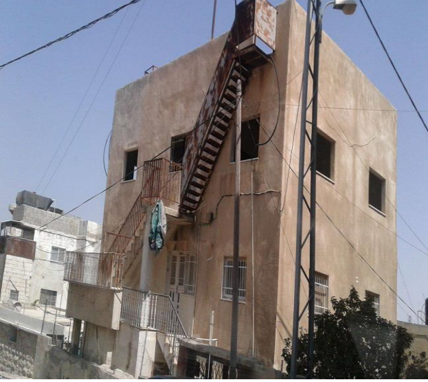
صورة (39) اسلاك الكهرباء قريبة جدا من البناء
