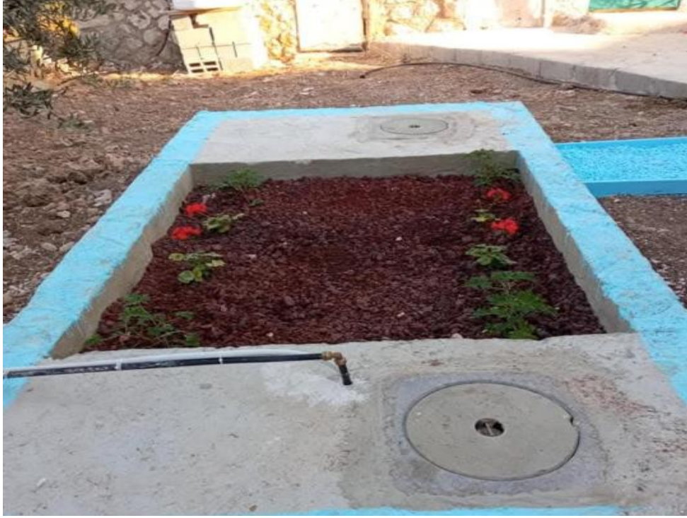
شكل 4.1: نموذج لوحدة معالجة مياه رمادية تم تنفيذها من قبل مركز أبحاث الأراضي في مدرسة ذكور بتير / محافظة بيت لحم
