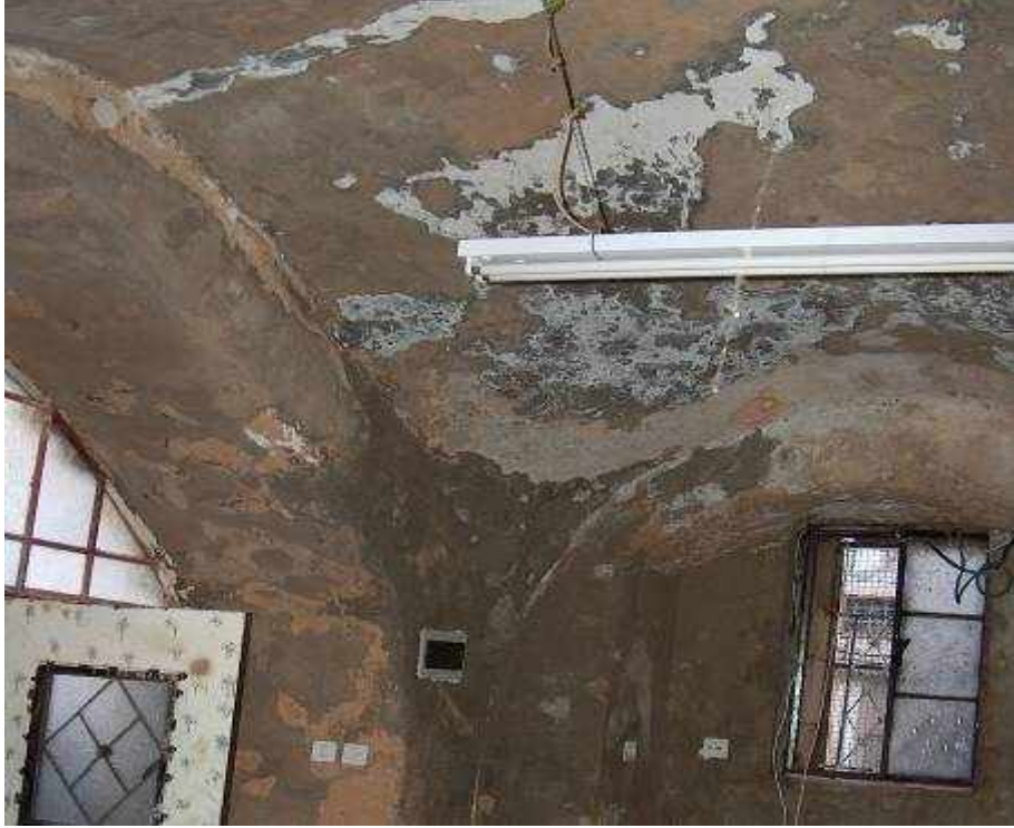
شكل 12.2: استخدام القصارة الاسمنتية في المباني القديمة عام 2007 المصدر: جمعية القدس للرفاه والتطوير
