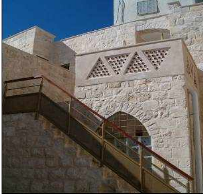
شكل 24.5: شكل لمشروع مركز الإرشاد الفلسطيني بعد ترميمه عام 2006م من قبل برنامج الإعمار التابع لمؤسسة التعاون المصدر: : مؤسسة التعاون
