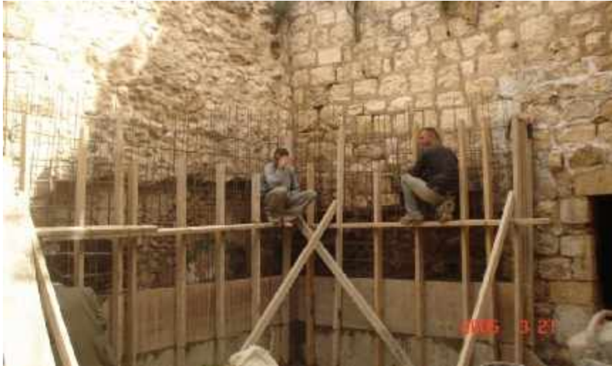
شكل 15.5: شكل يظهر وضع استخدام الخرسانة المسلحة لترميم وتدعيم احد الجدران المصدر: جمعية القدس للرفاه والتطوير
