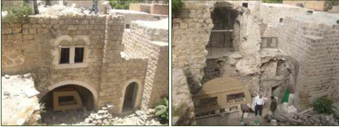
شكل 10.5: شكلان لاجدى واجهات المنازل التي تم ترميمها من قبل لجنة إعمار الخليل في البلدة القديمة في الخليل . المصدر: لجنة اعمار الخليل(2008)
