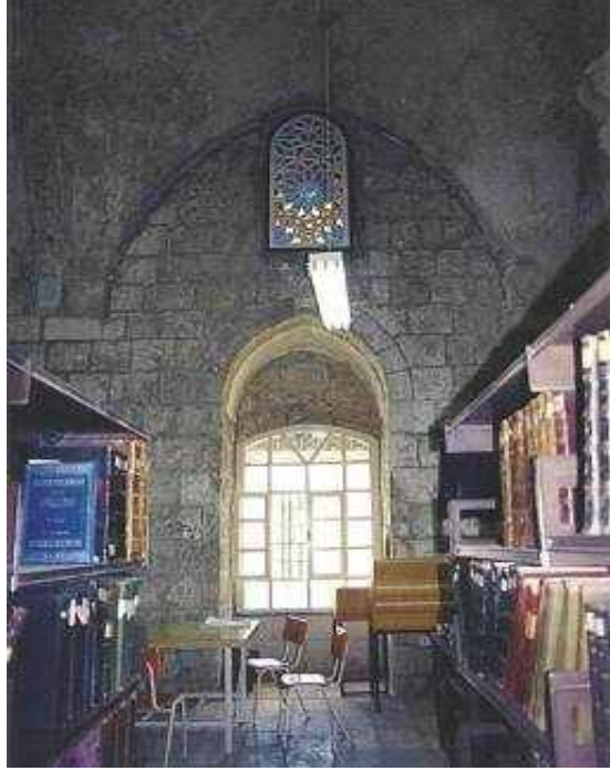
شكل 12.6: شكل للمبنى من الداخل للمبنى قبل الترميم (حيث يظهر استخدام القصارة الإسمنتية واثار الرطوبة بالجدران).
