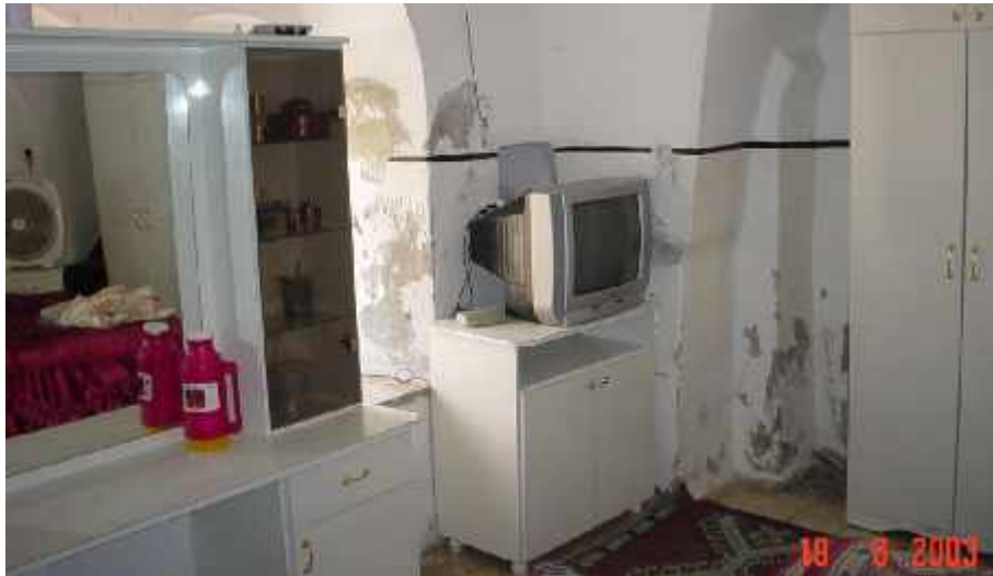
شكل 33.6: شكل تظهر بعض مشاكل الرطوبة واستخدام القصارة الإسمنتية سابقا في عقار إبراهيم غيث المصدر: جمعية القدس للرفاه والتطوير
