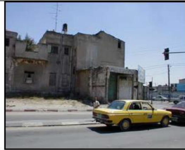
الشكل رقم (2-14): البناء آيل للسقوط
