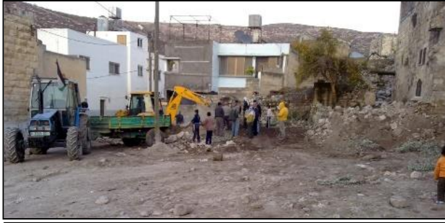
الشكل 2:24، أعمال الهدم والتخريب للمباني التاريخية. (المصدر): الباحث، 2011، قرية نصف اجبيل-نابلس.
