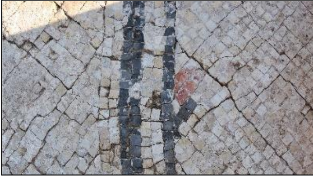
الشكل 4:94، وجود شقوق متعرجة، خربة الطيرة. (المصدر): الباحث، 2016.
