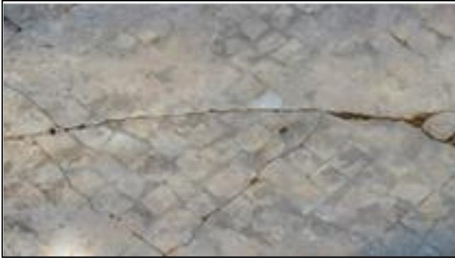
الشكل 4:95، وجود شقوق مستقيمة، خربة الطيرة. (المصدر): الباحث، 2016.
