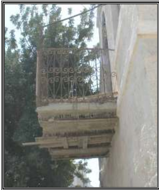
الصورة رقم "9.3": تظهر الدوامر التالفة قبل الترميم (المصدر: مركز حفظ التراث، 2008)
