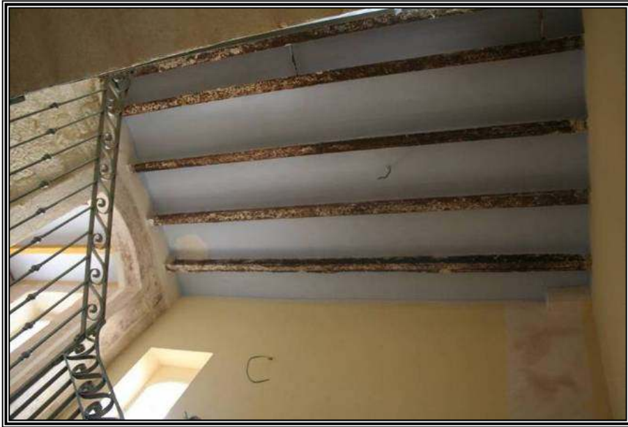
الصورة رقم "17.3": تظهر الدوامر التالفة قبل الترميم (المصدر: مركز حفظ التراث، 2008)
