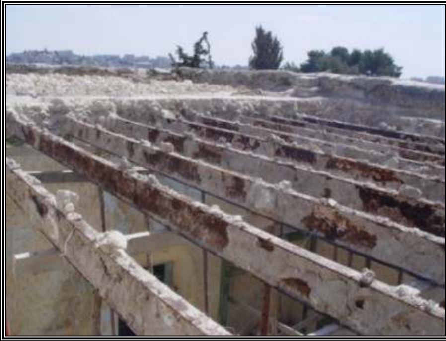
الصورة رقم "11.3": تظهر الدوامر التالفة التي تمت إزالتها (المصدر: مركز حفظ التراث، 2008)
