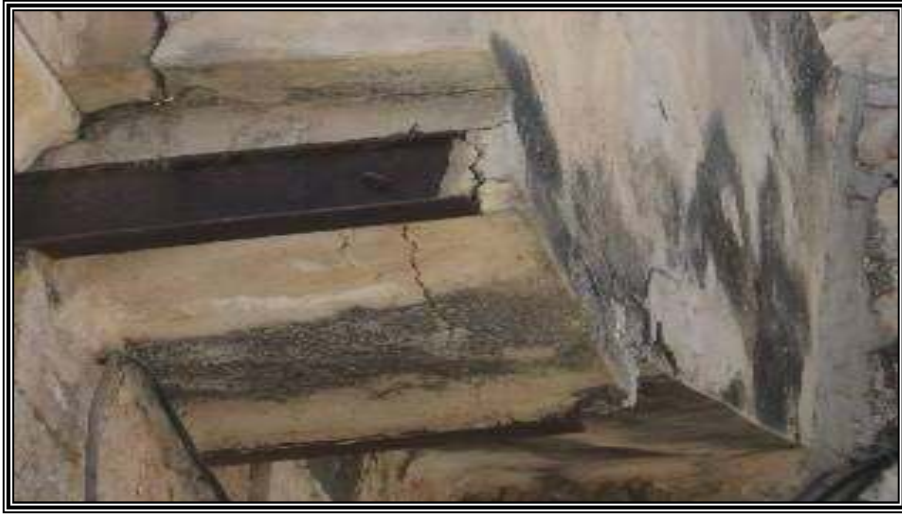
الصورة رقم "3.3": تظهر التشققات التي أحدثها الصدأ في الجزء الإسمنتي للمبنى (2007)
