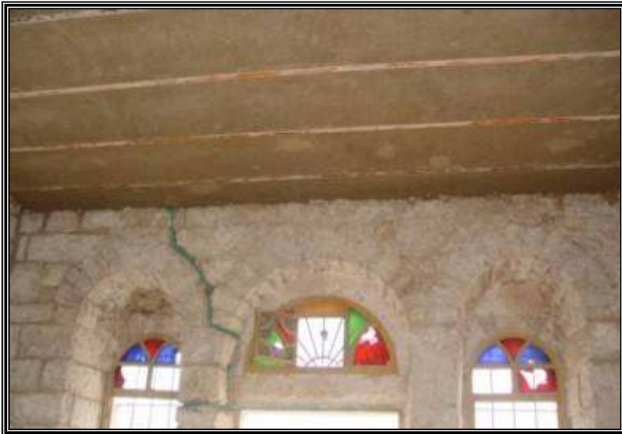
الصورة رقم "13.3": تظهر السقف التالف قبل الترميم (المصدر: مركز حفظ التراث، 2008)
