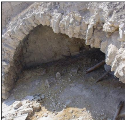
شكل رقم (22:6) الجزء العلوي من المبنى المهدم المصدر: تصوير الباحثة
