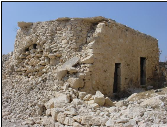
شكل رقم (15:6) صورة للواجهة الجنوبية المهدامة المصدر: الباحث 2005
