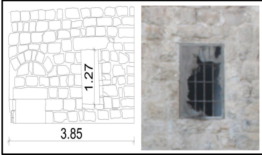
شكل 3.5: نماذج من النوافذ المفردة، بيت جبر عوض خليل وموسى السهم عصفور. المصدر: الباحث، 2013.
